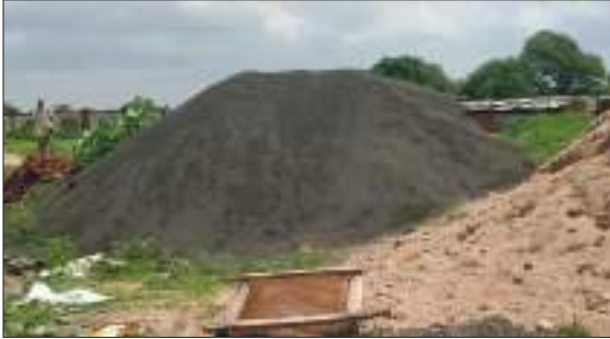
मौके पर निर्माण कार्य के उपयोग में ली जाने वाली रेत के साथ डस्ट जिसका उपयोग नींव भरने में किया गया।
